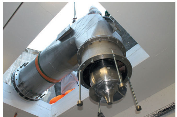
Montage de la turbine Diagonale de Montsalvens réalisée par la SARL Desgranges sur la base d'un profil hydraulique Mhylab (Q = 500 l/s, Hn = 40 m, Pm = 190 kW)
