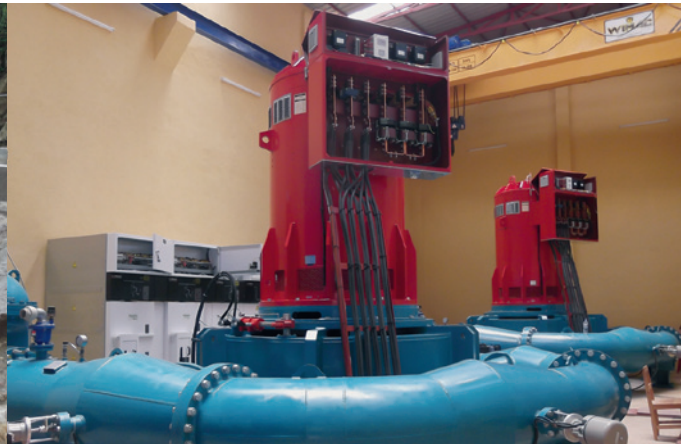
Giciye, Rwanda – Groupes Pelton fournis par la société Gugler durant la mise en service
