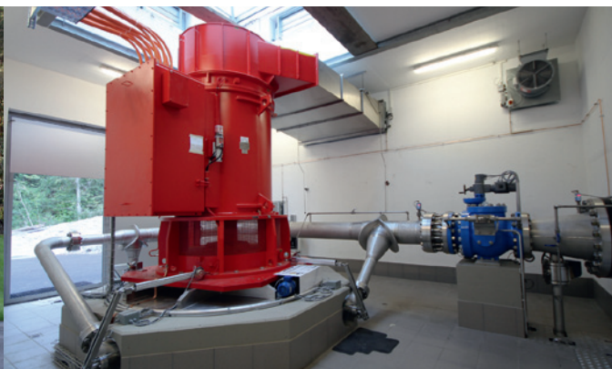
Le turbogroupe à 4 injecteurs de la centrale d'Icogne intégré au réseau d'irrigation ( Q = 473 l/s, H_n = 479 m, P_m = 1996 kW)
