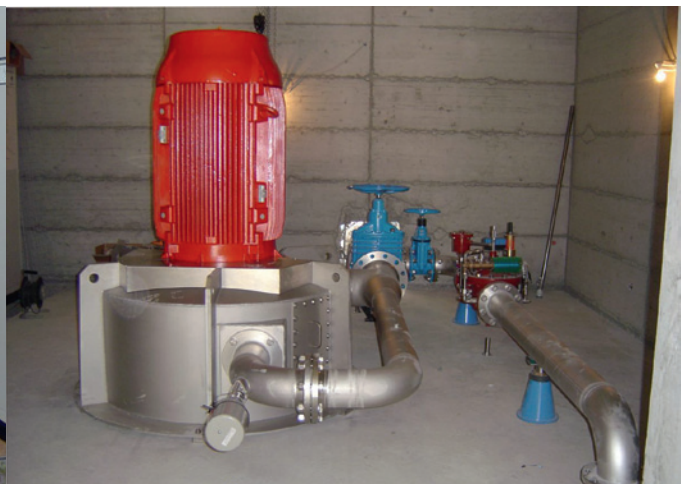
Le turbogroupe de Liddes Pallazuit (VS, CH) à 2 injecteurs, réalisé par Blue Water Power AG sur la base d'un profil hydraulique Mhylab ( Q = 150 \text{ l/s} , H_n = 162 \text{ m} , P_m = 214 \text{ kW} )
