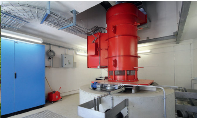
Le turbogroupe à 3 injecteurs de Rivaz II, réalisé par Gasa Hydro SA sur la base d'un profil hydraulique Mhylab ( Q = 500 l/s, H_n = 178 m, P_m = 781 kW)
